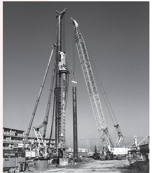
鋼管ソイルセメント杭工法 [HYSC (ハイエスシー)] 沈設風景
